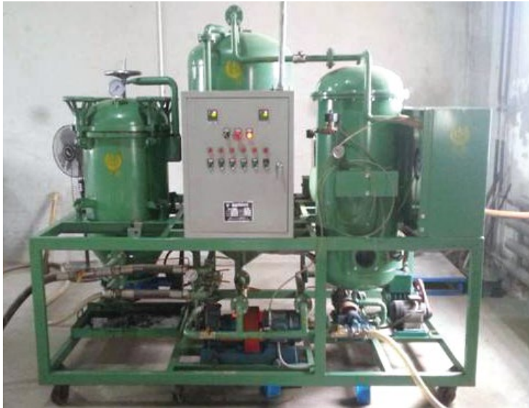
△ 废油回收装置
